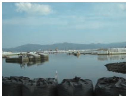
破壊されたままの防潮堤
