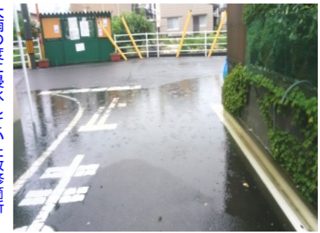
大雨の度に浸水していた改修箇所
