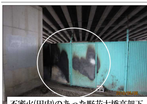
不審火(円内)のあった野花大橋高架下
