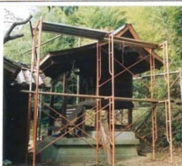
本殿の工事は順調に進んでいます。後1ヶ月ぐらいで工事も完成します 多くの町民のご参拝をお待ちしています。
