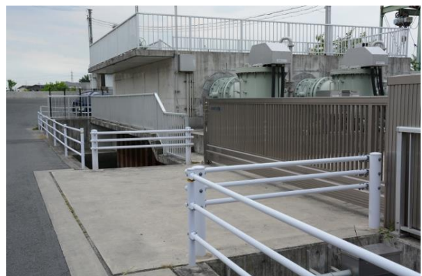
田中ポンプ場
