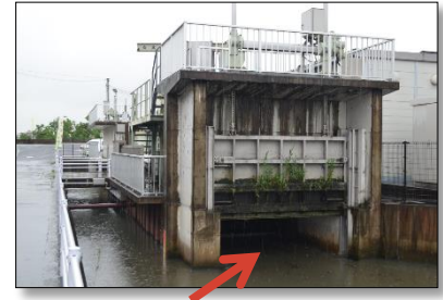
田中ポンプ場
