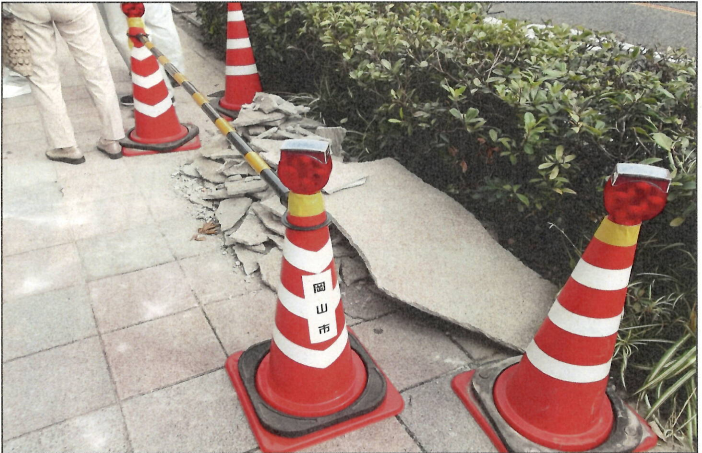
飛散外壁の一部
