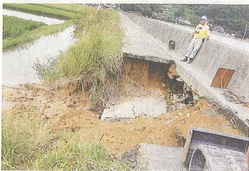
干拓締切堤防 決壊寸前
